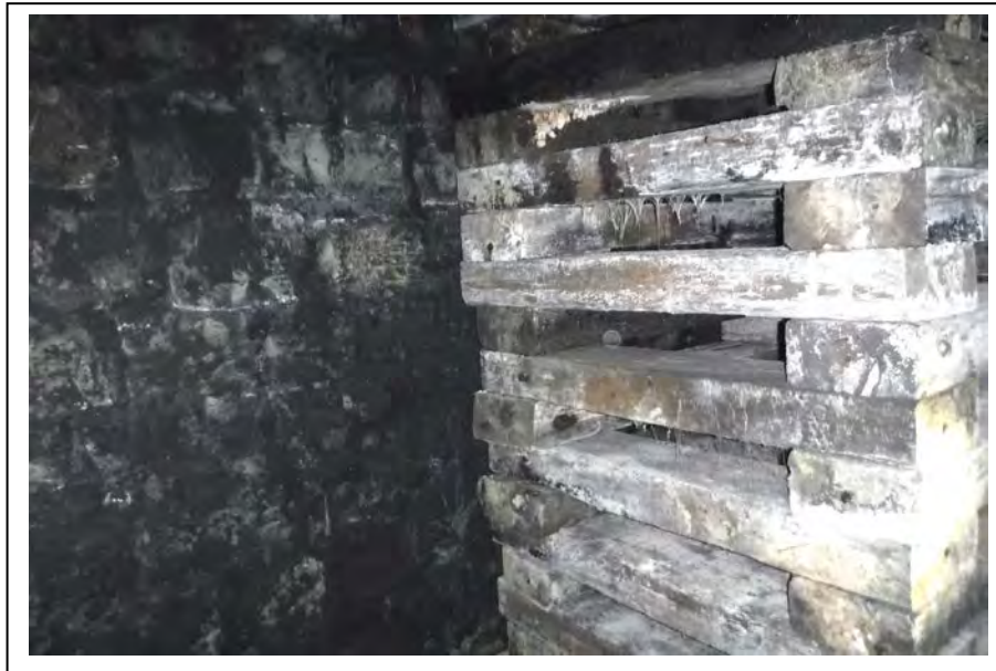
Photograph no C9: Cwg ② CE DS sidewall
