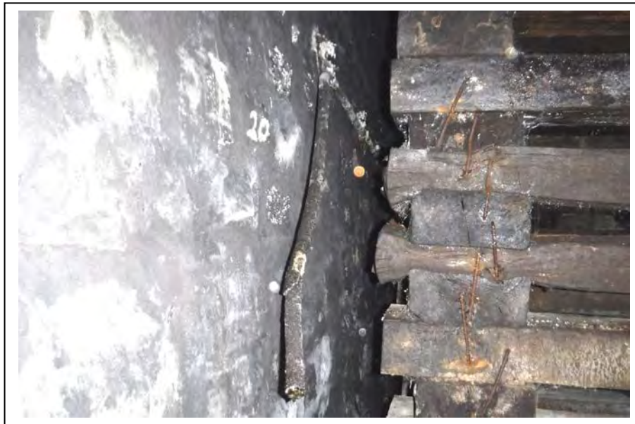
Photograph no C4: Cwg ① LE DS sidewall
